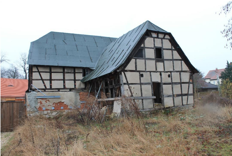
Ansicht Süd auf stark gefährdetes, leerstehendes Gebäude
